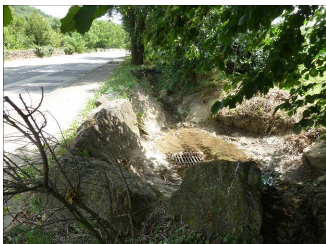
Passage d'un affluent dans un réseau busé le long de la D117, Millery (projet de déconnexion des eaux du lavoir)
